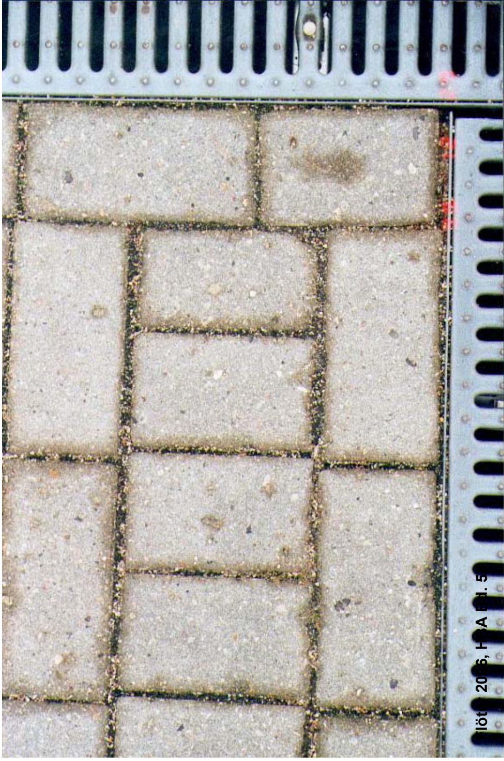
Foto 3: Testfeld 1 - Das für die Abstreuerung im Winter verwendete Sand-Kies-Gemisch bleibt auf den Moosen der Pflasterdecke liegen und wird nicht in die Fugen eingetragen (Aufnahmedatum 29.12.99)
