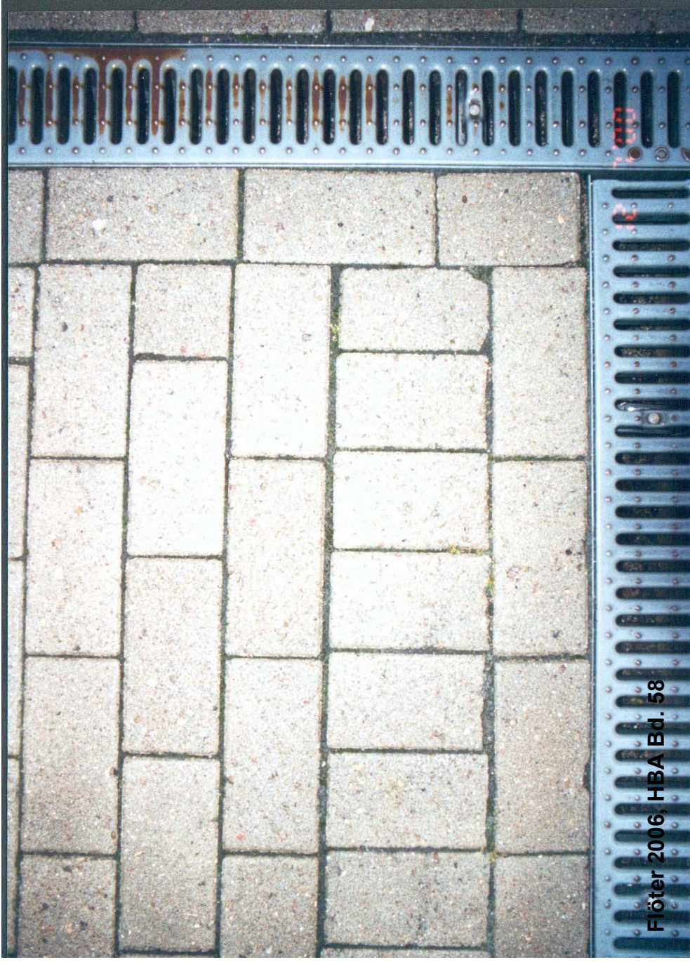
Foto 2: Testfeld 1 - Pflasterdecke aus Betonrechtecksteinen. Lysimeteranlage Bullerdeich. Die Wuchshöhe der Moose ist durch den Verkehr auf die Höhe der Oberfläche der Pflasterdecke beschränkt (Aufnahmedatum 12.07.00)
