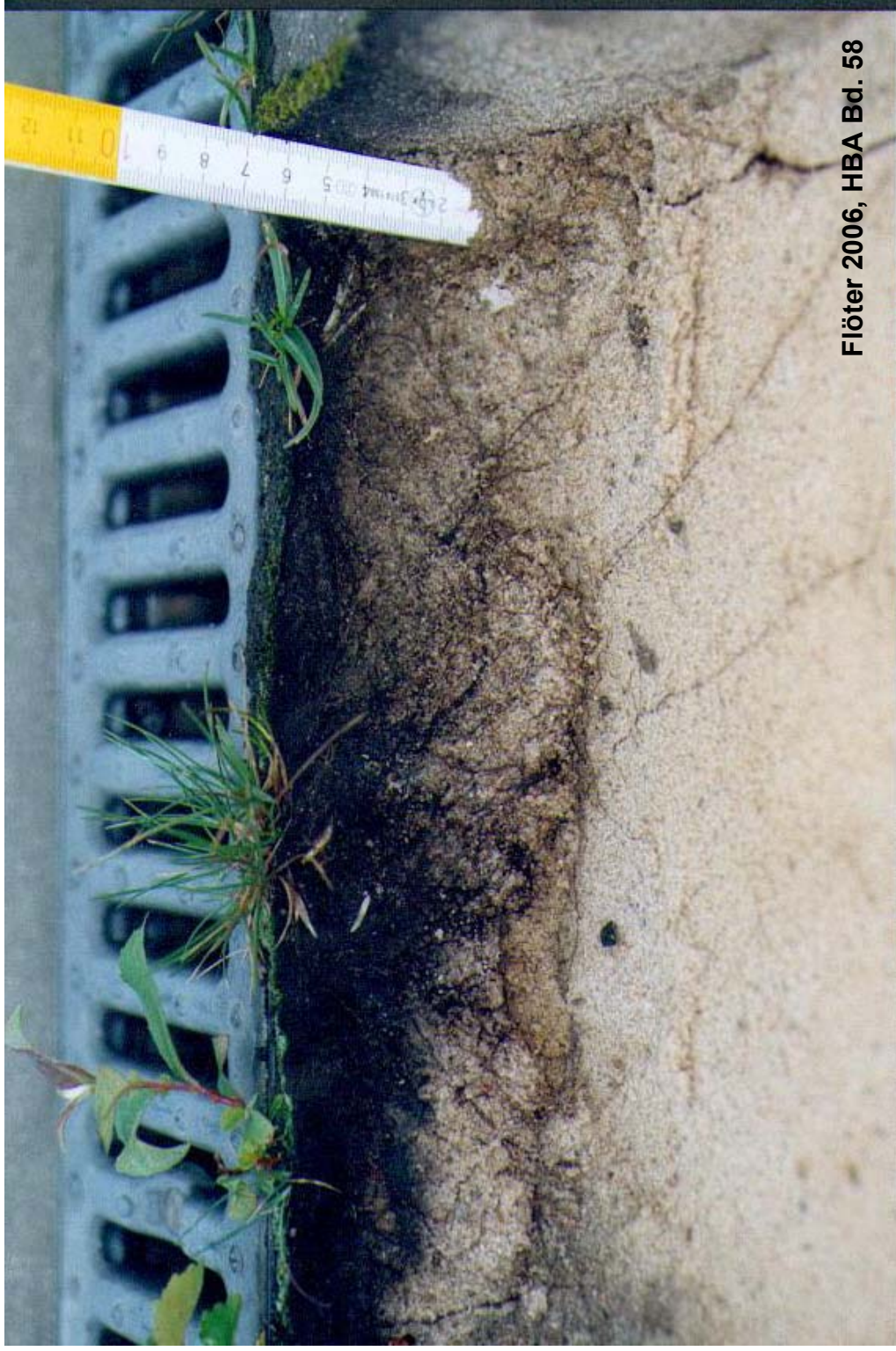
Foto 12: Testfeld 3 - Plattenbelag. Lysimeteranlage Bullerdeich. Der gesiebte Sand 0/2 mm war nach 48 Monaten in den oberen 3 cm verbraunt und sehr stark durchwurzelt. Unterhalb von 3 cm war der Sand kaum verändert aber noch stark durchwurzelt (Aufnahmedatum 12.07.00)
